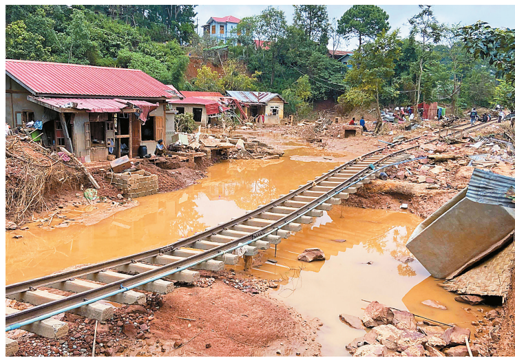
在洪灾中被损毁的铁轨。
