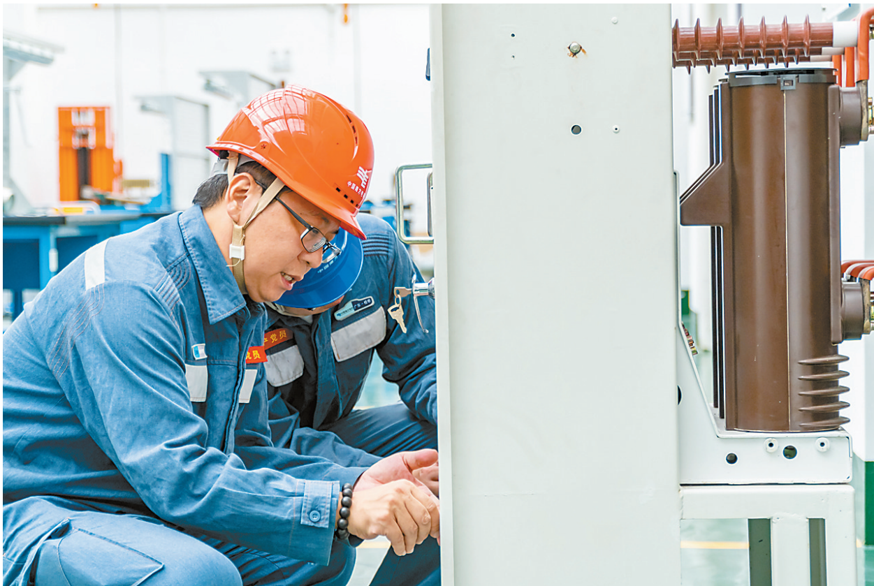
王啸峰在变电检修现场。
